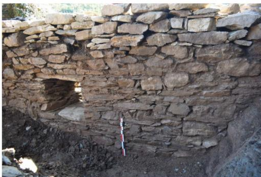
Fig. 6 : Château de La Roque (81), Espace 2, vue du parement nord du mur MUR092 et du jour JOU092r
